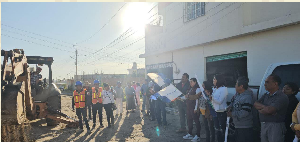
Foto tomada el 18 de diciembre de 2023 Inicio de Obras de Agua y Drenaje.
