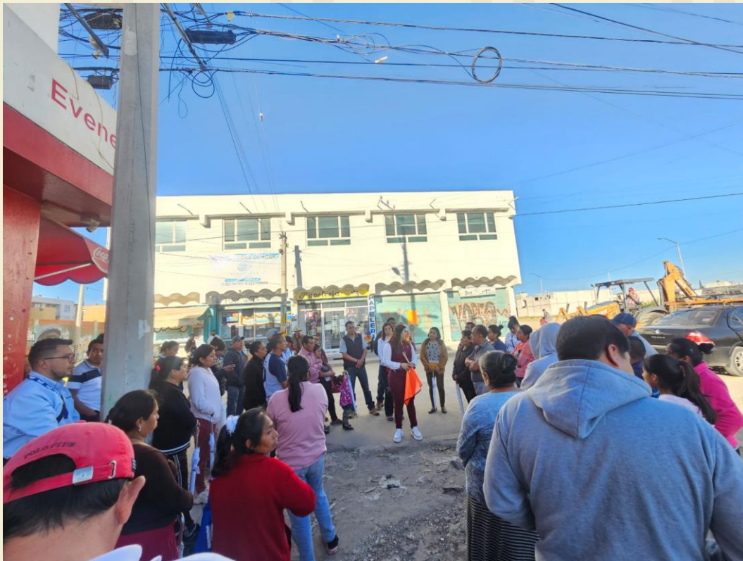
Foto tomada el 18 de diciembre de 2023 Inicio de Obras de Agua y Drenaje,
